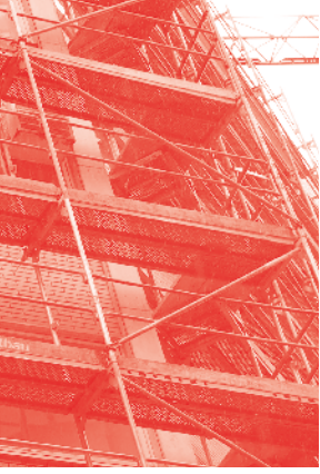
Umbau von Büros zu Wohnungen, Haus- projekt NiKa Frankfurt Bahnhofsviertel →siehe Seite 36
